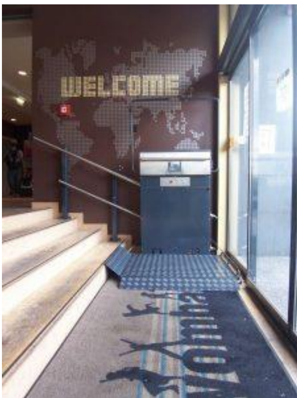
Fitness centrum Rakúsko. s čelným nástupom v obmedzenom priestore.
